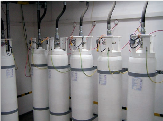
Баллоны системы автоматического газового пожаротушения в контрольной установке 22/4. Применен газ инерген, безвредный для здоровья человека
