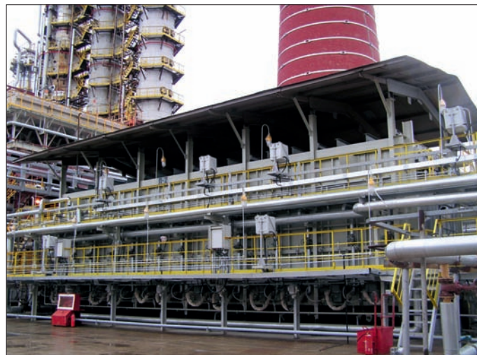
Печь П-1 после реконструкции с автоматизацией управления
