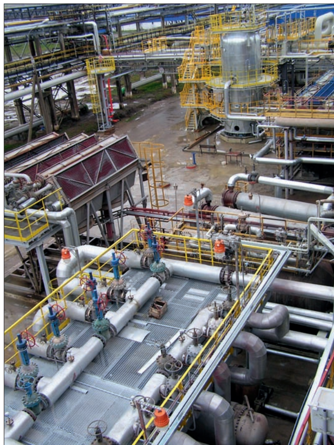
Обвязка блока теплообменных аппаратов
