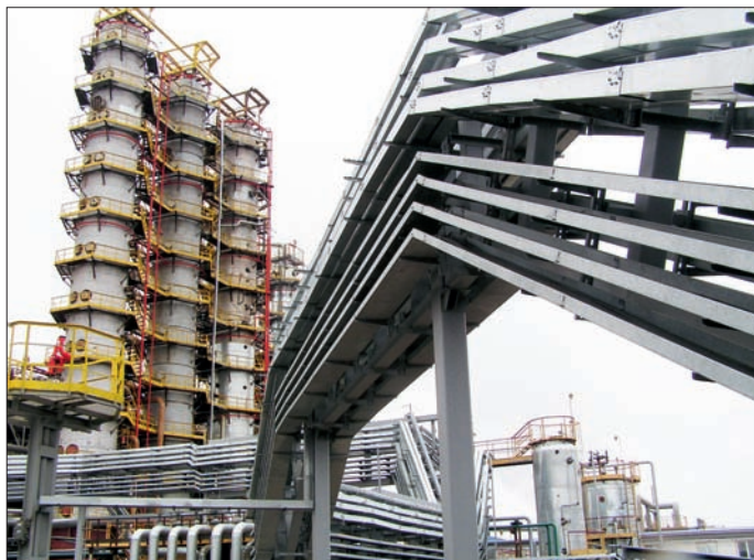
Кабельная эстакада от электроподстанции и контроллерной для кабелей АСУ ТП и электрокабелей
